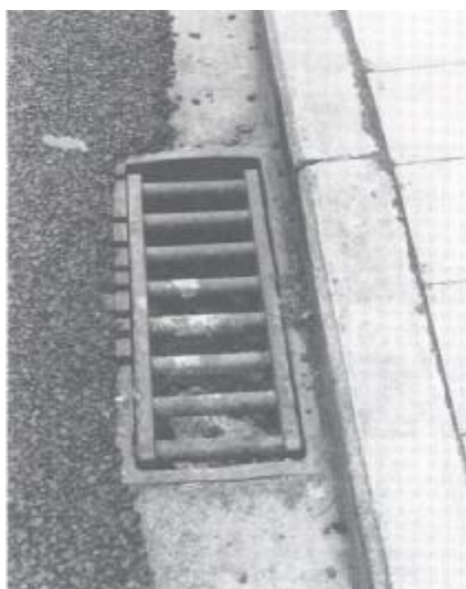
شکل ۸- برشهای دندان‌ه‌ای در بخش فوقانی آبرو جهت ایجاد شرایط لازم برای زهکشی آب جمع‌شده در آسفالت متخلخل
